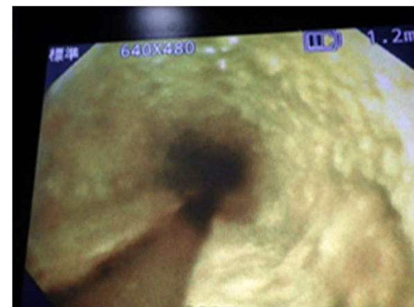
汚泥(スラッジ)の蓄積写真
