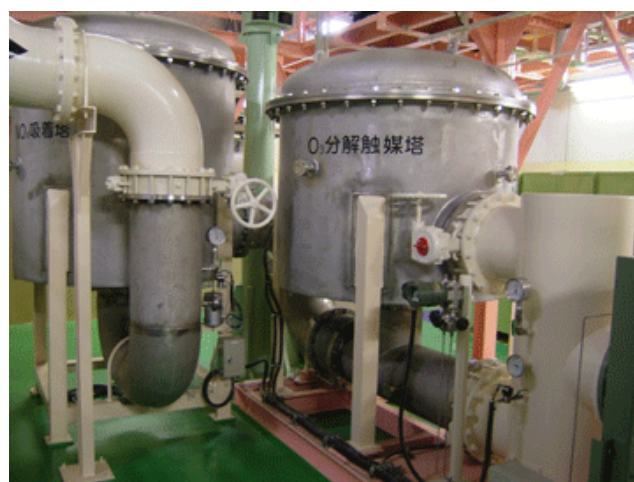
特許のガス処理装置
